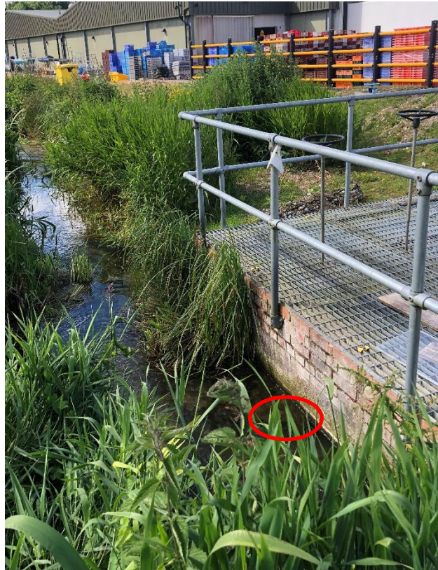
Outlet 3b: B, C effluent
