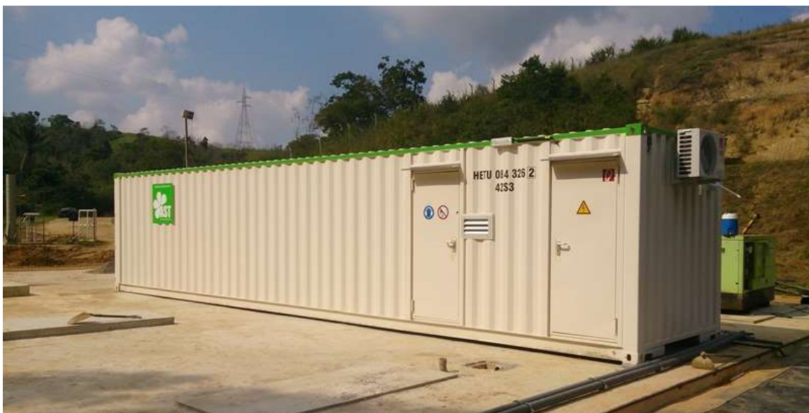
Figure 9: Reference: Landfill site in São Gonçalo – Rio de Janeiro (Brazil) 120 m 3 /day (31 700 gpd).
